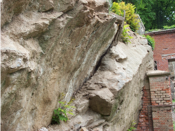
Fot. 5. Widoczna szczelina między blokami wypełniona zwietzeliną, która przejmuje wody opadowe.
