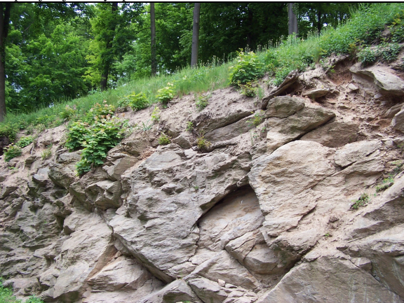
Fot. 7. Widok zwietrzałych skał grożących obrywom.
