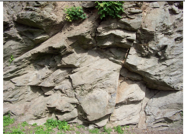
Fot. 8. Widok zwietrzałych skał grożących obrywom.
