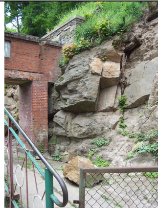
Fot. 4. Widok obrywu skalnego o ciężarze 0,30 t leżącego na drodze wewnętrznej.
