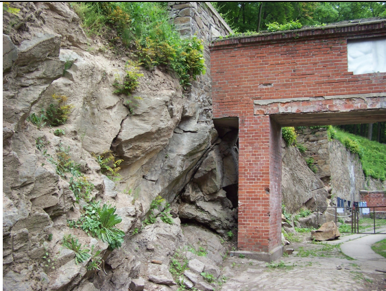
Fot. 3. Widoczna zwietrzała skała przy podporze tunelu łączącego budynek gospodarczy (obecnie mieszkalny) z zamkiem.
