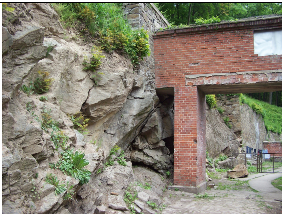
Fot. 3. Widoczna zwietrzała skała przy podporze tunelu łączącego budynek gospodarczy (obecnie mieszkalny) z zamkiem.
