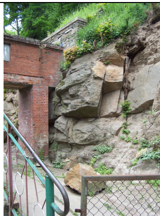
Fot. 4. Widok obrywu skalnego o ciężarze 0,30 t leżącego na drodze wewnętrznej.
